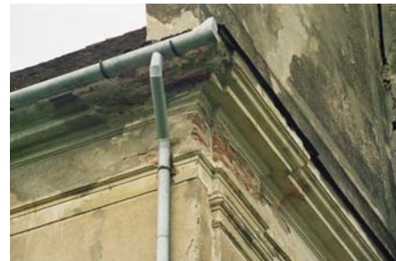
Schadhaftes Dach mit Feuchtigkeitsschäden im Mauerwerk
