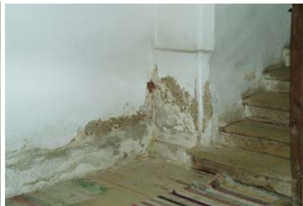
Feuchtigkeitsschäden am Aufgang Jugend
